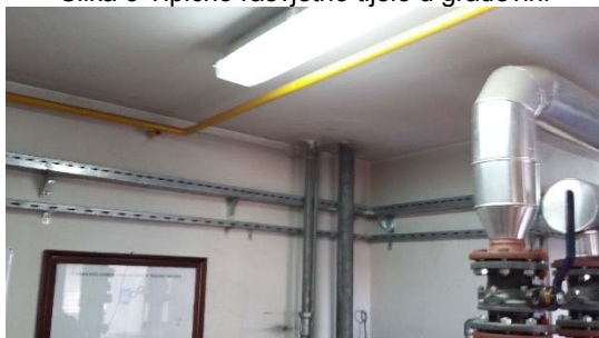
Slika 5 Tipično rasvjetno tijelo u građevini
