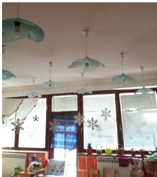
Slika 2 Tipično rasvjetno tijelo u građevini
