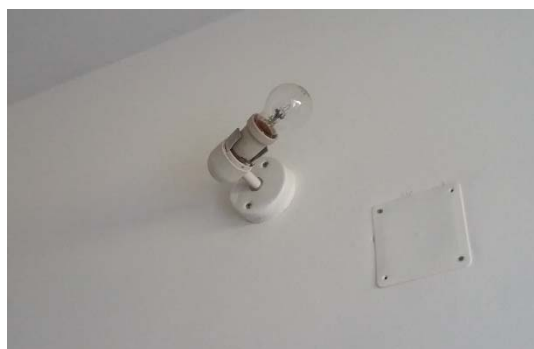
Slika 4 Tipično rasvjetno tijelo u građevini
