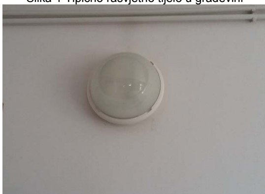
Slika 3 Tipično rasvjetno tijelo u građevini
