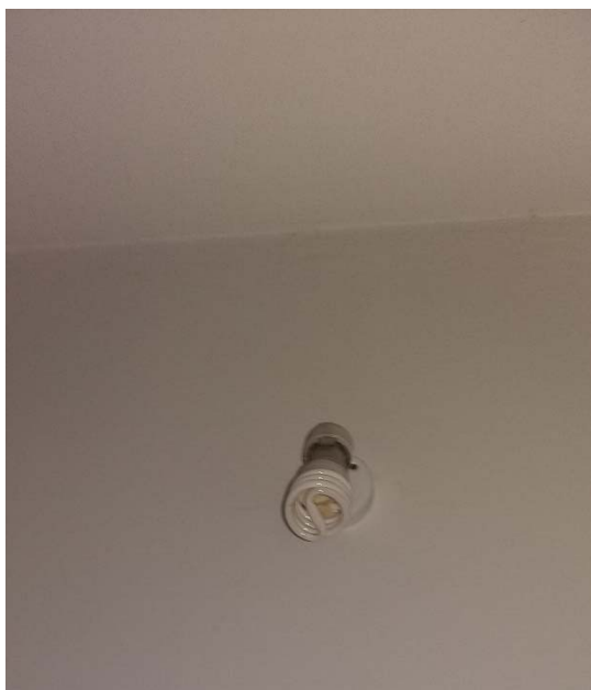
Slika 1 Tipično rasvjetno tijelo u građevini
