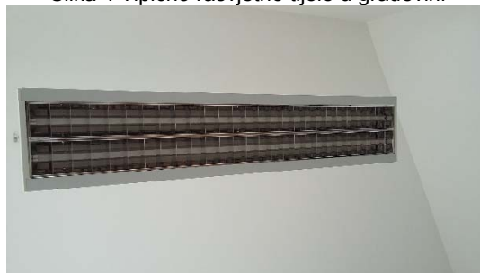
Slika 6 Tipično rasvjetno tijelo u građevini
